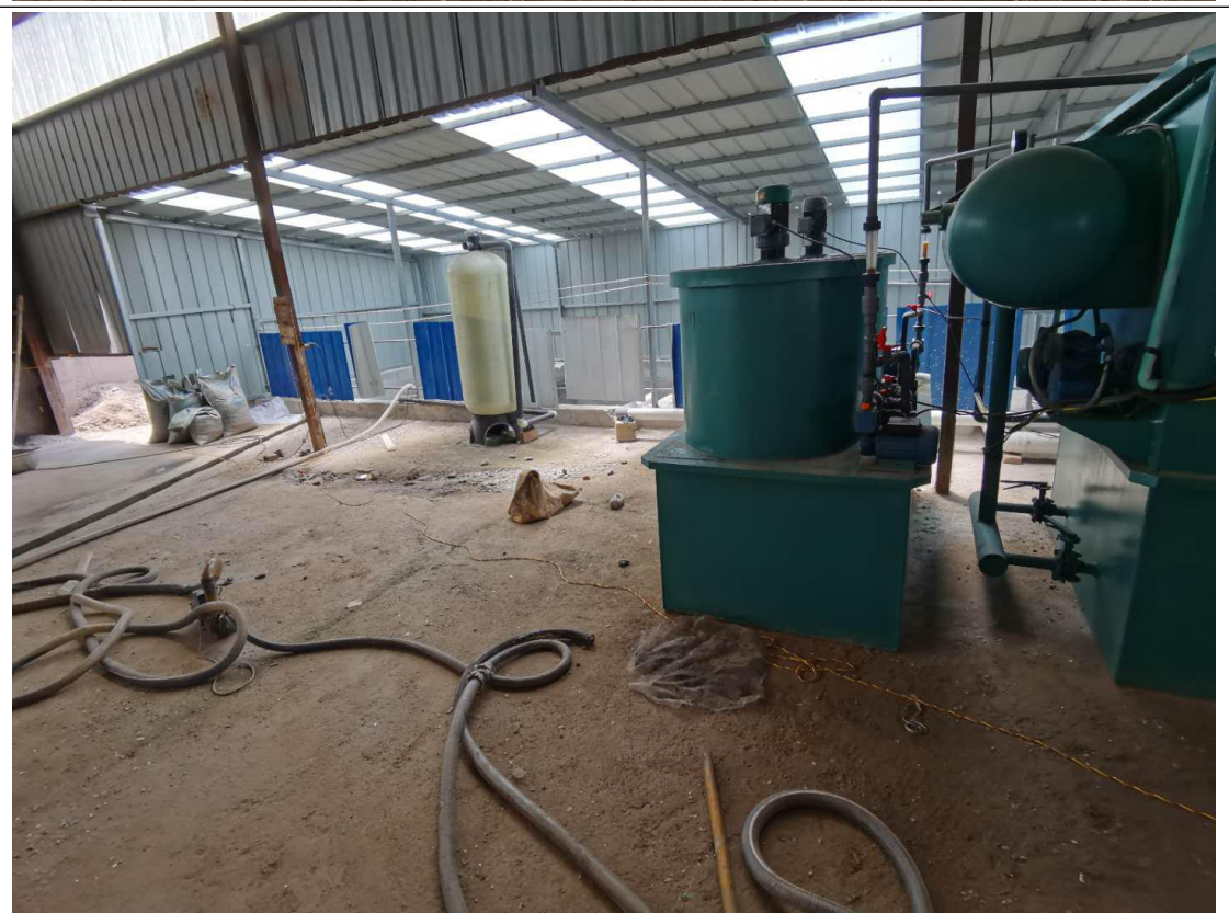
污水处理设施
