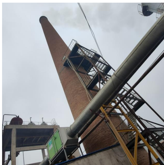
SNCR 脱硝+多管除尘+3 套布袋除尘器+排气筒
