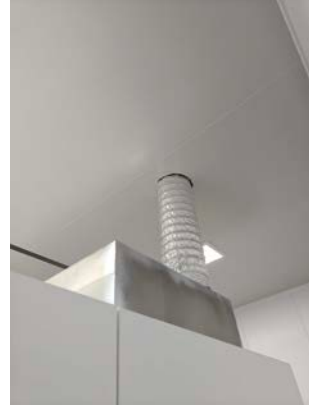
图 3-3.8 工业 CT 上方排风管道
