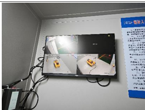
图 3 操作室内视频监控器显示屏
