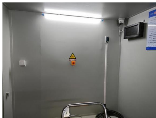
图 2 探伤室内视频监控器探头、固定式辐射监测仪探头、紧急停机按钮
