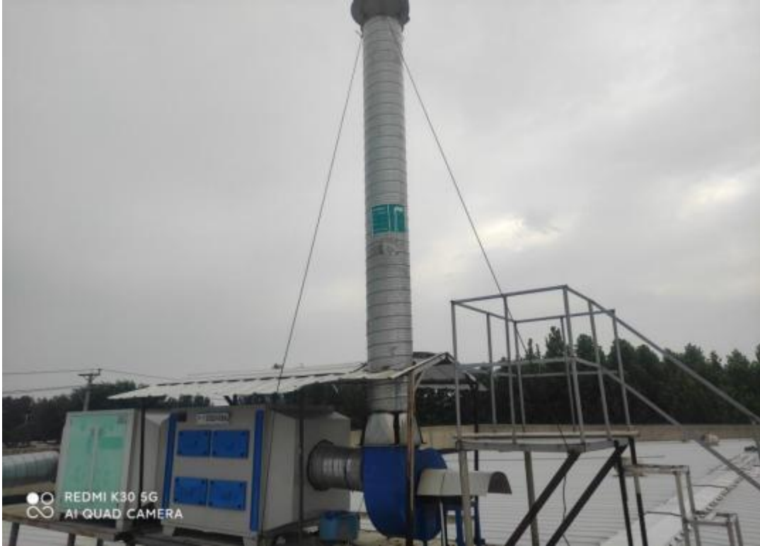
图3 生产四区废气排放筒 DA005
