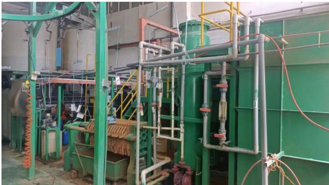
图 4-3 污水处理站照片
