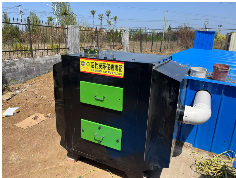
图 4-1 废气处理设施图片
