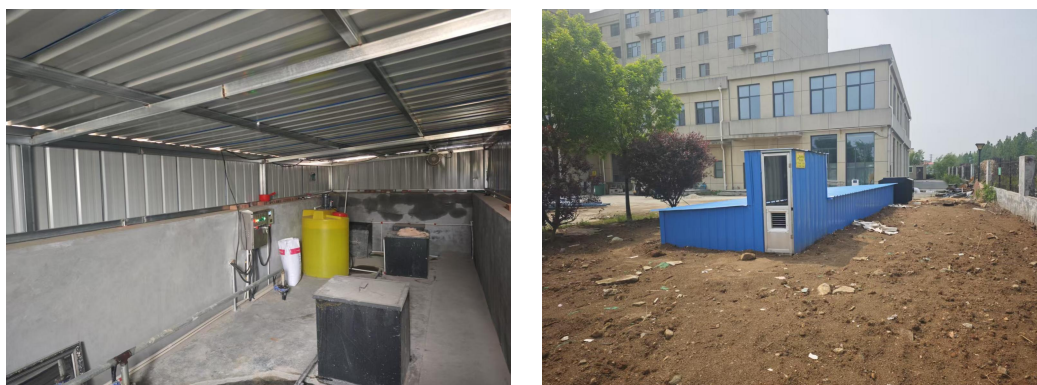
图 4-2 污水处理站图片
