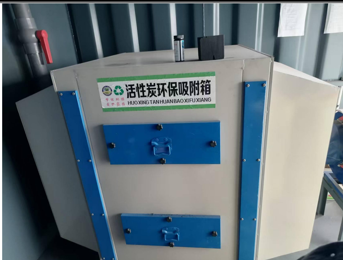
图 4-1 废气处理设施图片
