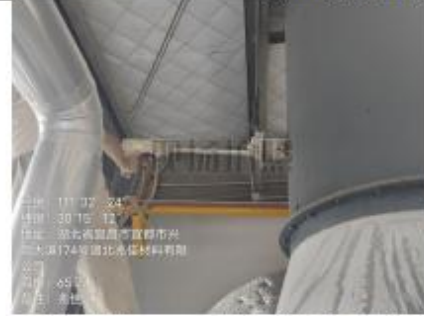
干燥废气排放口 DA003 有组织排放废气检测点位
