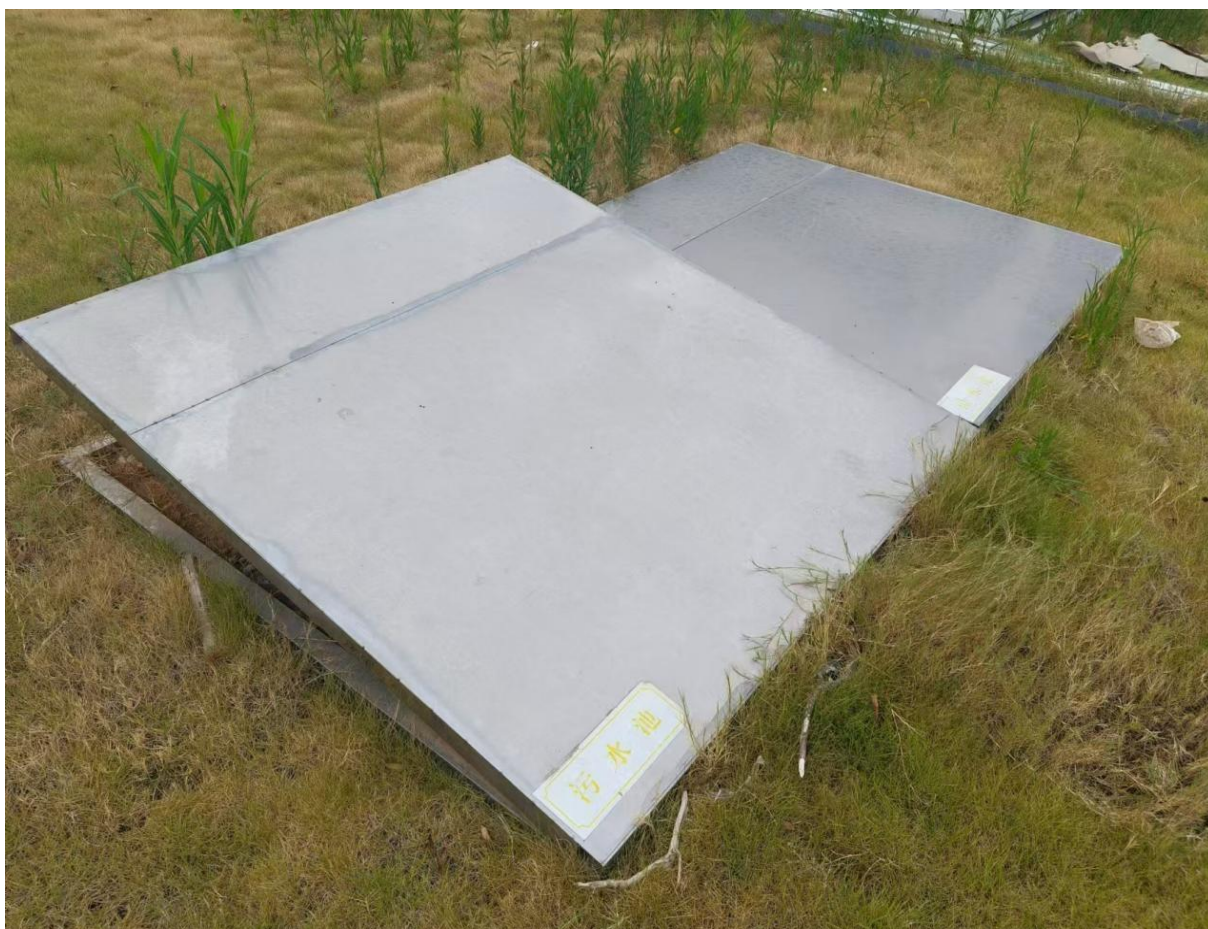
图 4.2-3 初期雨水沉淀池
