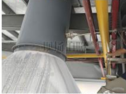
干燥废气排放口 DA002 有组织排放废气检测点位
