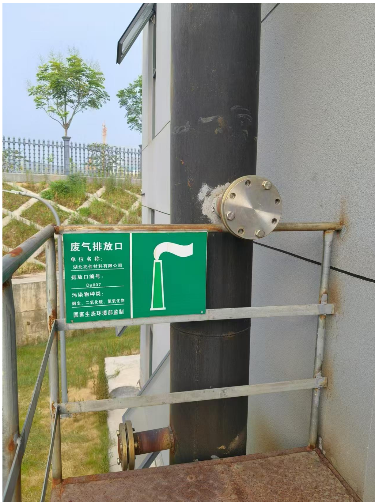
图 4.1-17 废气排放口 DA007
