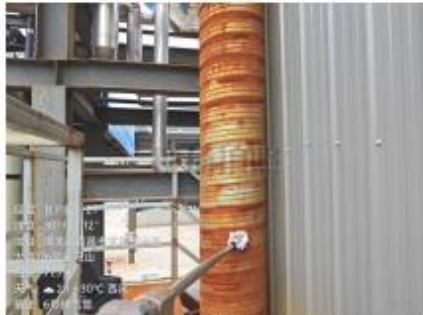
密胺产品反应釜排放口 DA006 有组织排放废气检测点位
