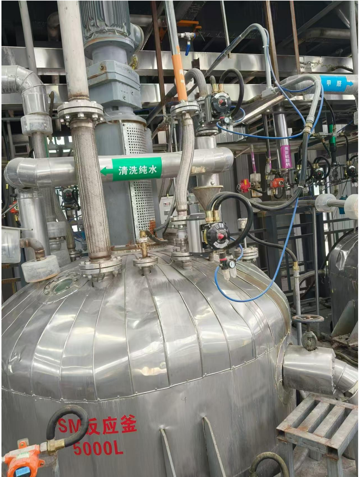
图 4.1-9 合成反应釜尾气收集装置
